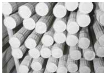
排ガス処理設備(ろ過式集じん器内部)
